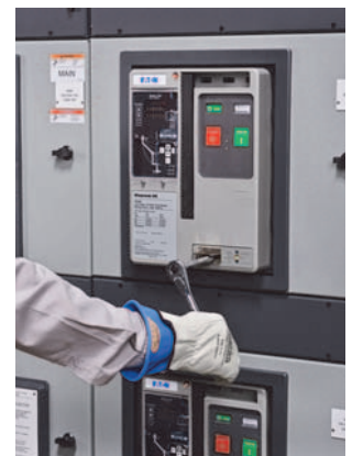
Levering Magnum DS Breaker
