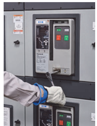
Levering Magnum DS Breaker
